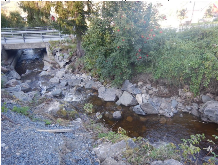
Bilde 5: Erosjonsskader i elva. Tørrmursteinen er borte og tatt av bekken på bildet
