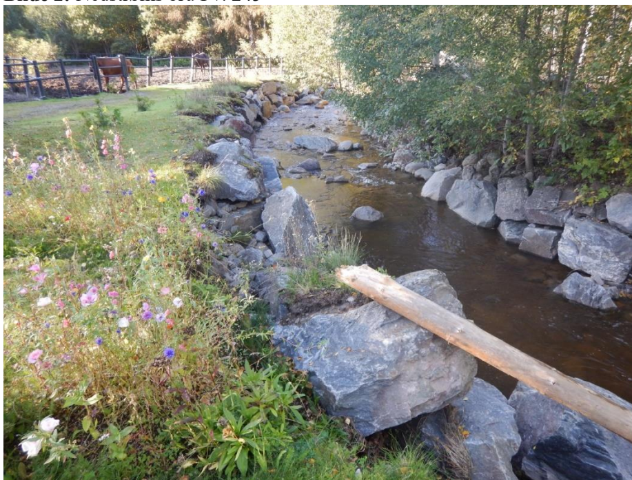
Bilde 3: Fundament til stein gravd ut. Tørmuren vil kollapse med tiden
