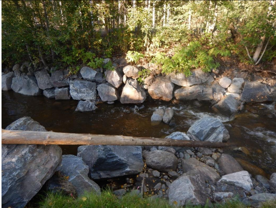
Bilde 4: Oppstrøms bru. Tørrmur ser ut som et (u)ordnet steinlag- Mye av steinen setter seg fast oppstrøms vegbrua i området og demmer opp elva. Gått sørpeskred i elva.
